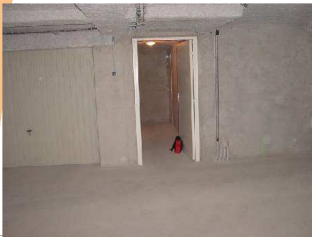
Indication des issues de secours (absence de blocs lumineux)
