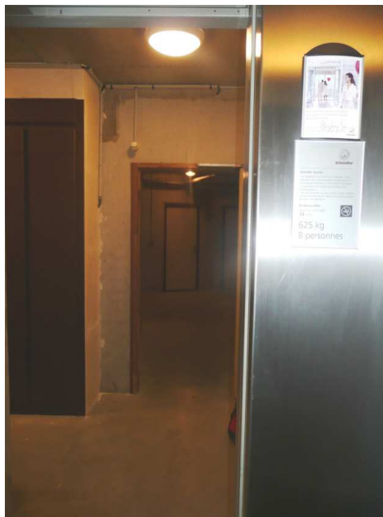
Absence de sas entre les caves (sous-sol) et l'ascenseur
