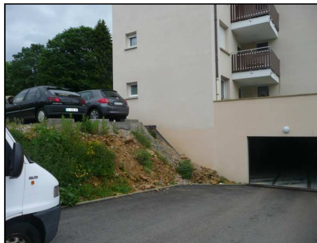
Absence de protection Ht de chute > à 1m
