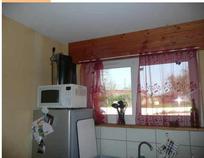
Entrée d'air dans une pièce de service
