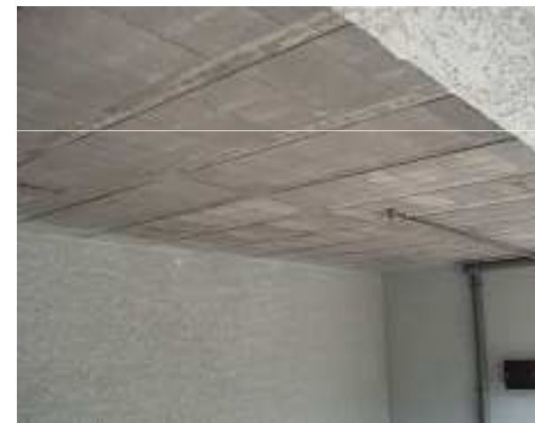
Absence d'isolant en plancher haut dans parc
